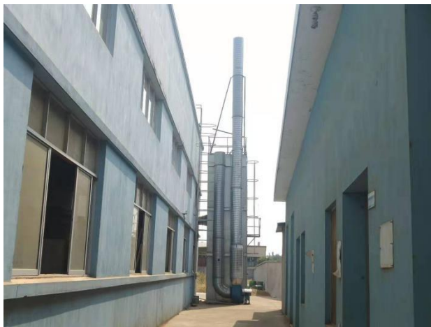
图3-2 项目中央集尘处理设施
