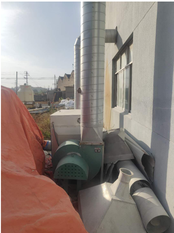
图3-3 挤出、注塑工序有机废气处理设施
