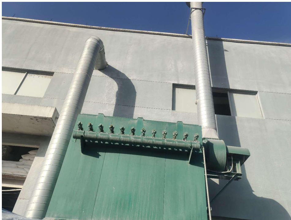
图3-1 项目投料、搅拌下料、加料粉尘处理设施
